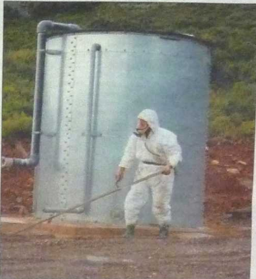
Des cuves pleines d'eau sont disposées sur le chantier afin d'assurer l'aspersion du terrain amiantifère.
